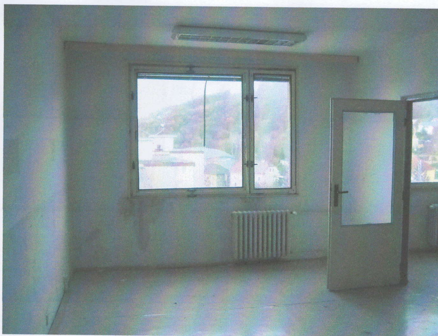
Obr. 06. Na západním průčelí dochází k zatékání dešťové vody nefunkčním oplechováním parapetů
