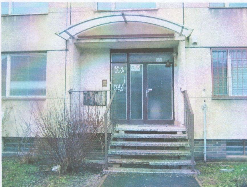
Obr. 03. Hlavní vstup do budovy v úrovni 1.n.p. po předloženém schodišti má poškozené teracové stupně
